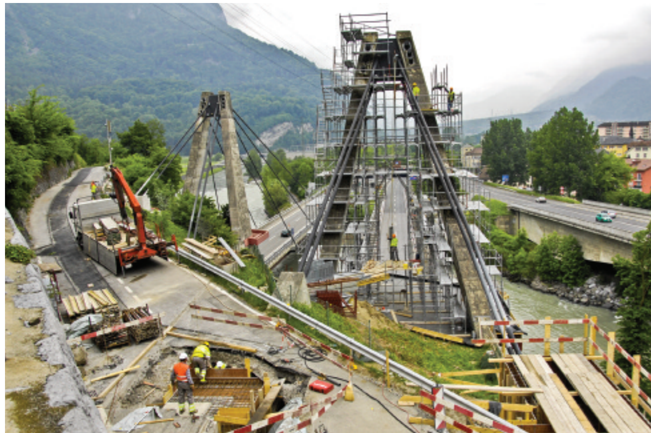
Autobahn Bex–Martigny Brücke über die Rhone bei St Maurice : Übersicht über die Baustelle
